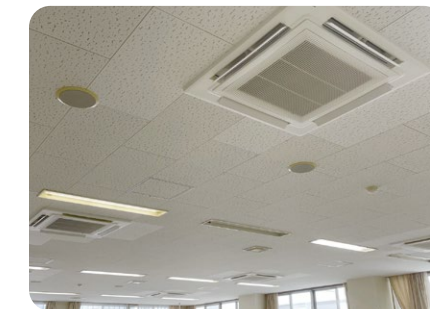
GHP室内機 / 照明
