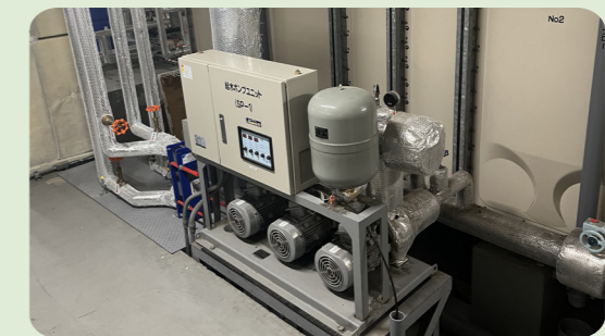
加圧給水ポンプ
