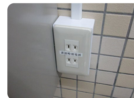
非常用コンセント
