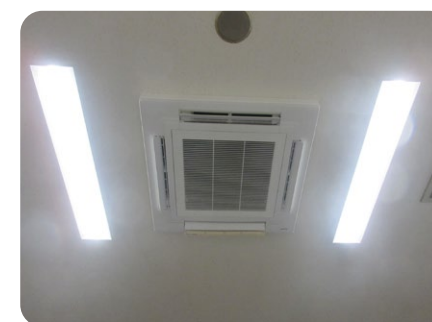
空調および非常用照明
