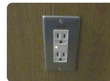
非常用コンセント
