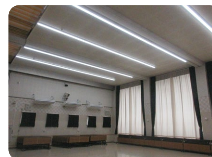
空調および照明
