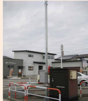
▲子局ガバナ、銅管柱及び遠隔監視制御盤
