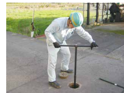
バルブ開閉器の操作
