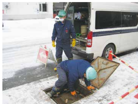
子局(6条9丁目) ガバナー室 地下ピット入口
