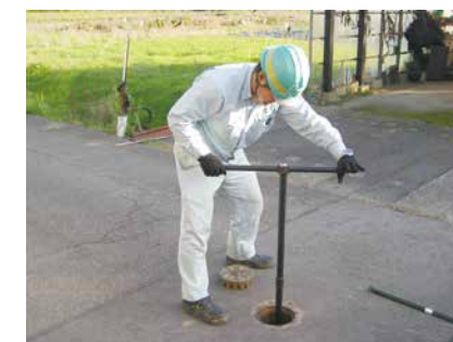
バルブ開閉器の操作
